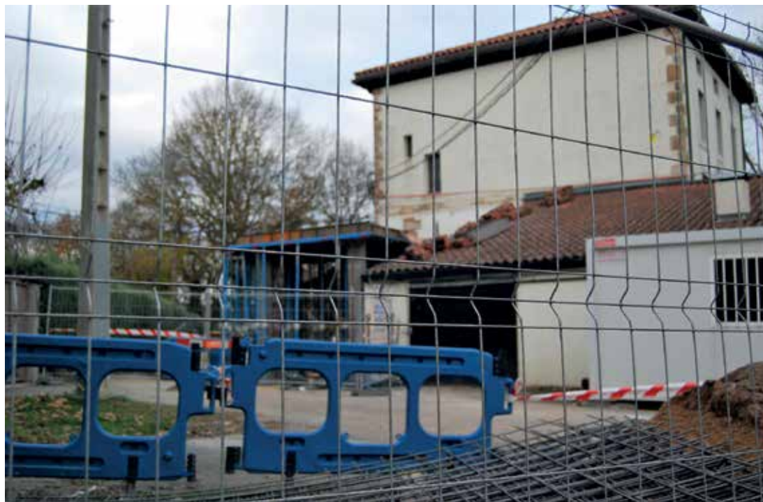
Las escaleras, el ascensor y los baños se construirán en un módulo exterior, lo que permite no interrumpir las clases.
